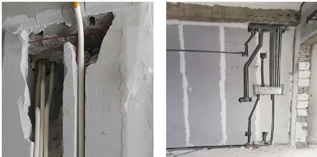
图4 传统非管线一体化板造成墙面后期施工破坏、水电预埋偏差大
